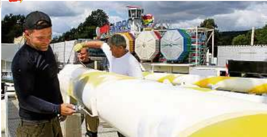
Die Vorbereitungen für das Vogelschießen in Rudolstadt laufen: Uwe Schieck, Inhaber des Europa-Rades (rechts), streicht auf der Bleichwiese mit seinen Kollegen Robert und Christian die Stahlträger für das Riesenrad. Foto: Heike Enzian
